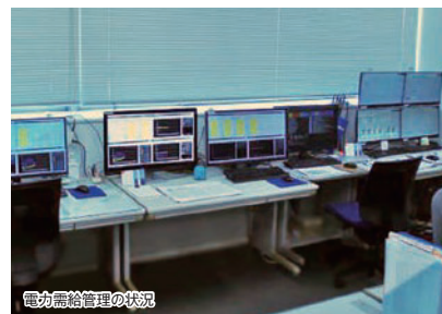
電力需給管理の状況
